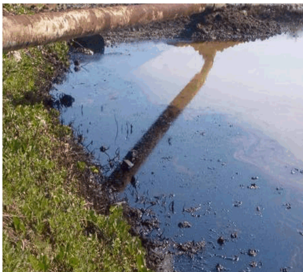
Foto 3. Derrame de los lodos por rompimiento de los diques de contención del sistema de piscinas que interrumpen el camino. Obsérvese la mancha de petróleo
